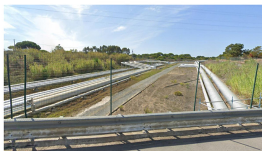
Figura 4.53 – Esteira de tubagens vista da A26-1
